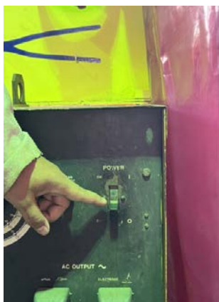
รูปที่ 2.23 แสดงการปิดเครื่องเชื่อมทุกครั้งที่ทำงานเสร็จ
