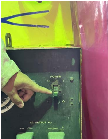
รูปที่ 2.17 ต้องปิดสวิตช์หรือถอดปลั๊กก่อนซ่อมหรือปรับเครื่องทุกครั้ง
